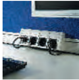
Verkabelung: Energie- und Datenfluss immer am richtigen Ort.
